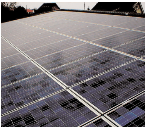
Bild 4: Ansicht Modulfeld mit U-förmigen Klemmen (sichtbare horizontale Modulabstände)
